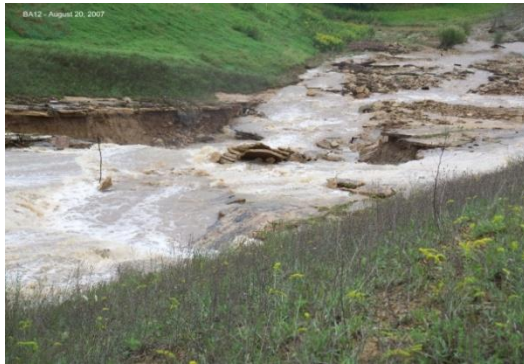
Bad Axe 12 Aux. Spillway Damage-Aug. 2007
