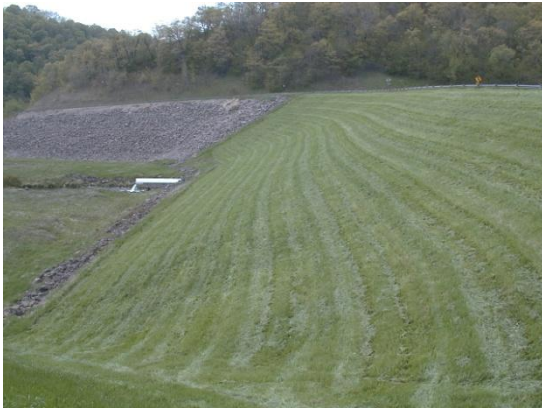
2:1 Embankment Mowing Bad Axe 12
